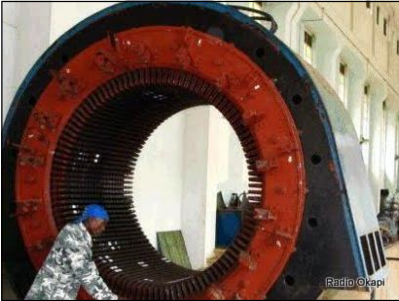
Le stator du groupe 2 de la centrale hydro-électrique de Bendera sur la rivière Kiyimbi près de Kalemie (Tanganyika). Ph. François-Xavier Mybe.
